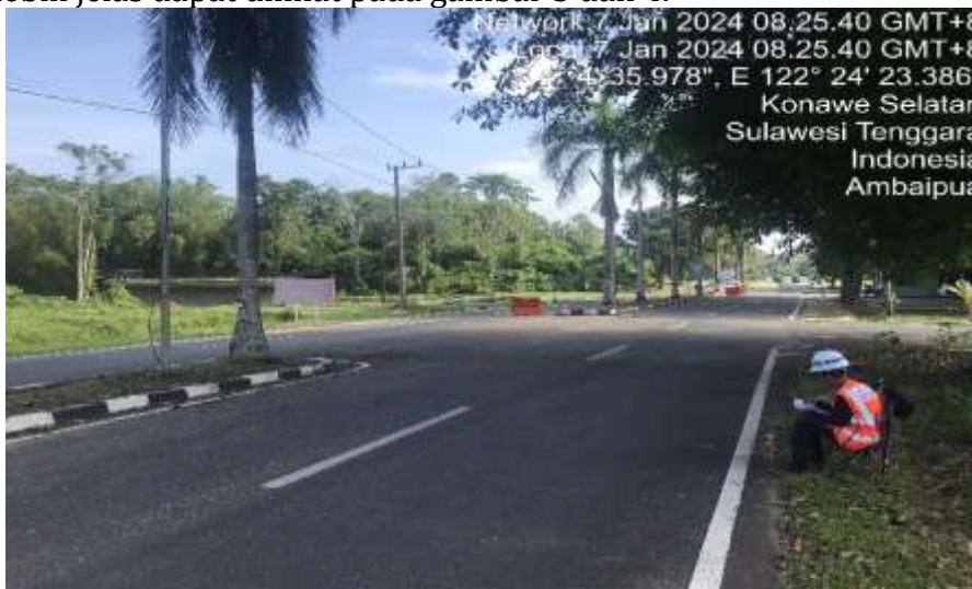
Gambar 2. Kondisi Ruas Jalan Bandara Haluoleo
