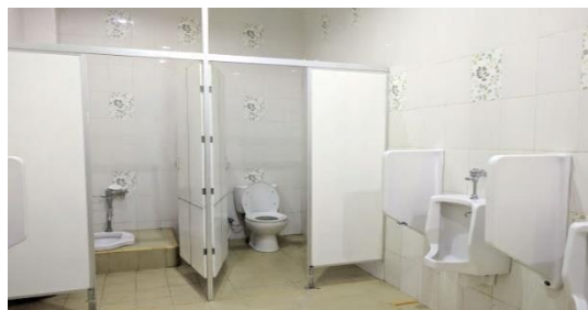
Gambar 2. Kondisi Toilet Bandar Udara Tebelian
