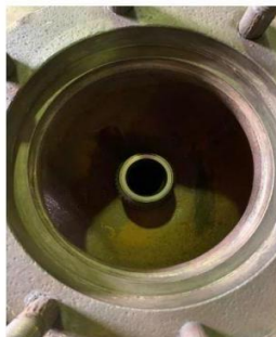
Gambar 3. Nuzel pada SaFety Valve
