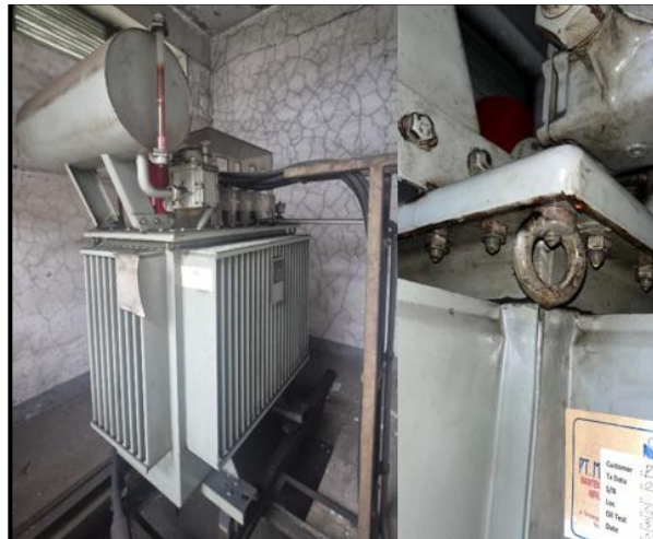
Gambar 1. Kondisi Fisik Transformator Eksisting Gardu ILS (Sumber: Dokumentasi Penulis, 2026)
