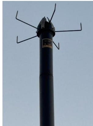
Gambar 2. Air Terminal ESE KURN R150 pada Atap Gedung MPH 2
