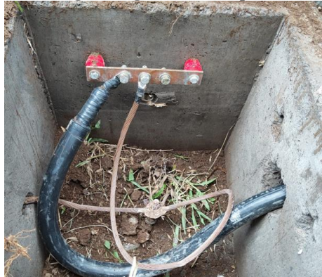
Gambar 3. Bak Kontrol Pembumian (Ground Pit) Gedung MPH 2
