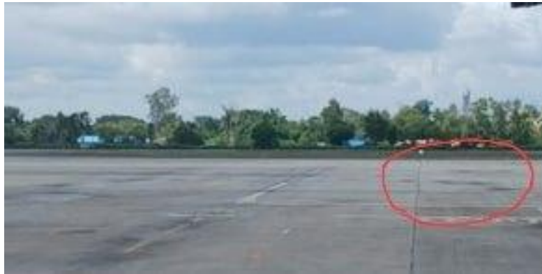
Gambar 2. Tumpahan Minyak ( Oil Spillage ) pada Permukaan Apron (Sumber: Dokumentasi Penulis, 2026)
