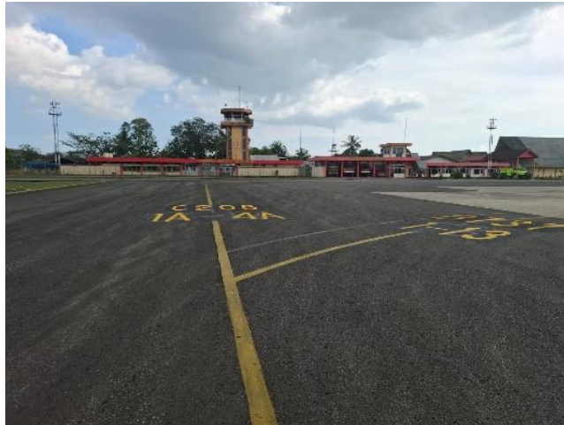
Gambar 2. Kondisi Taxiway Alpha BLU Kantor UPBU Kelas I Utama Juwata
