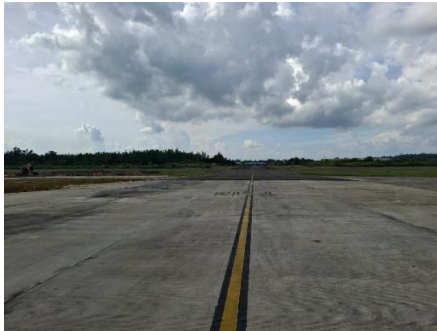
Gambar 1. Kondisi Taxiway Bravo BLU Kantor UPBU Kelas I Utama Juwata
